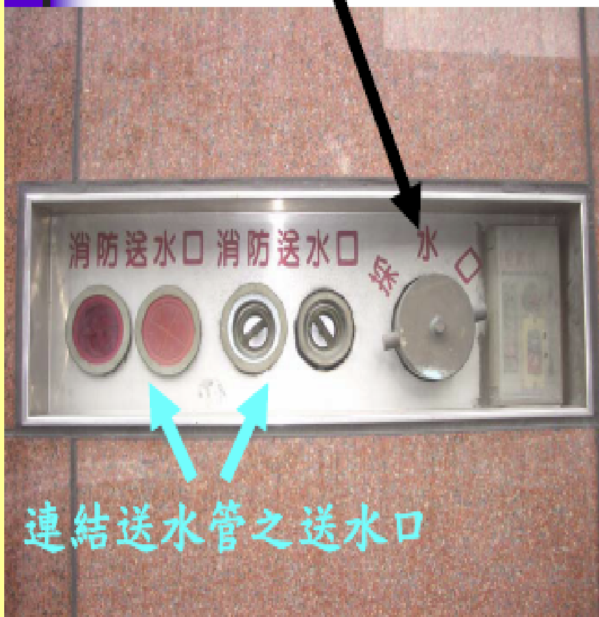
消防專用蓄水池之採水口
