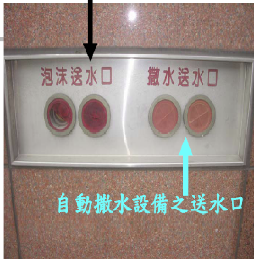
泡沫設備之送水口
