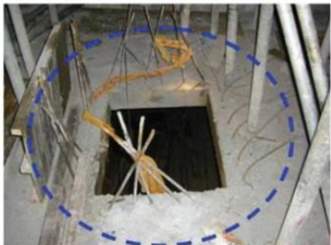
勞工蘇○○由地下1樓中間樁開口(尺寸為90x66公分)墜落
